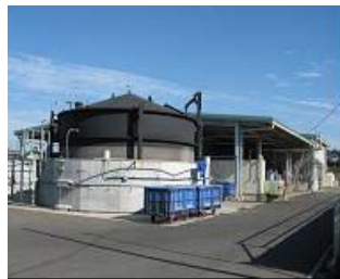
メタン発酵槽
