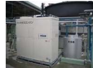
コジェネレーション設備
